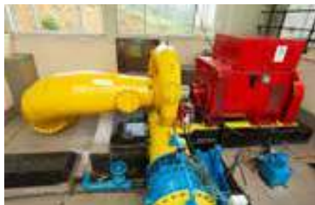
Mini Hydro - Somerset Estate
